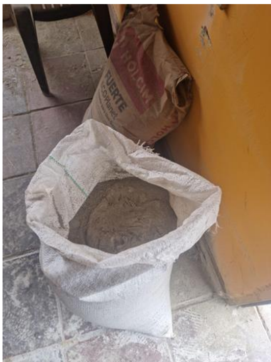
Cemento en deterioro
